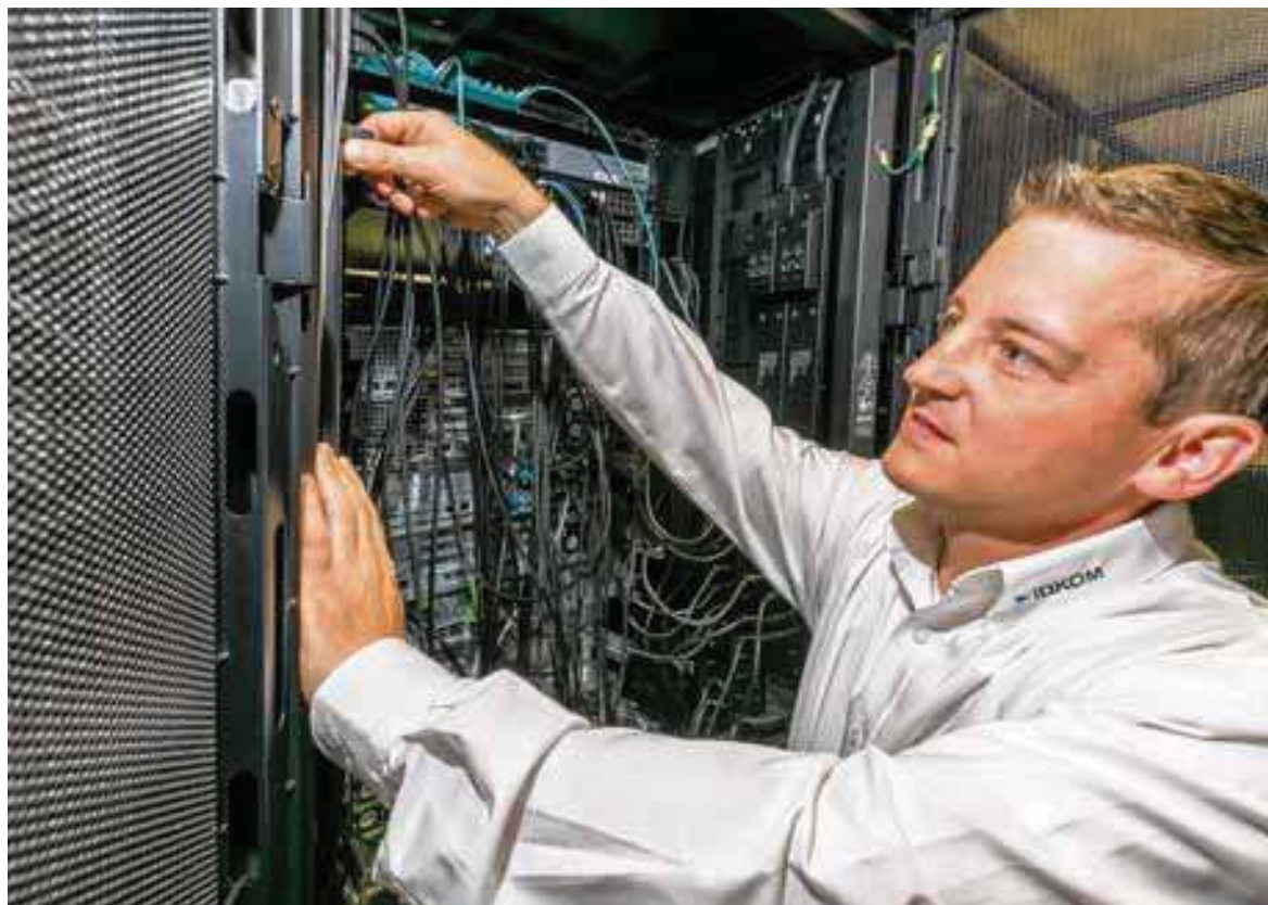
IT-Ingenieur Andreas Juli am Rechenzentrum in Kempten. Oft kommt er hier nicht her, höchstens um einmal defekte Teile auszutauschen, ein Kabel umzustecken oder den Server eines neuen Kunden zu installieren. Fotos: Ralf Lienert
